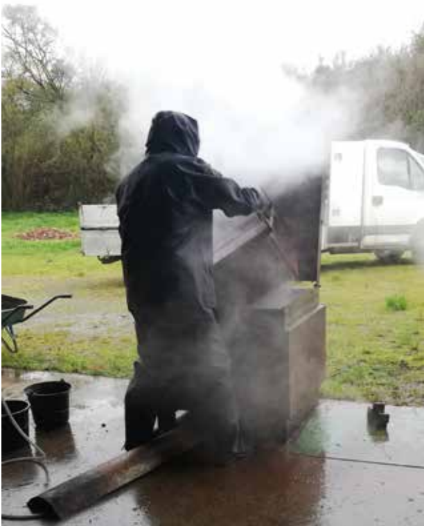
Fabien sortant les cadres de la chaudière
